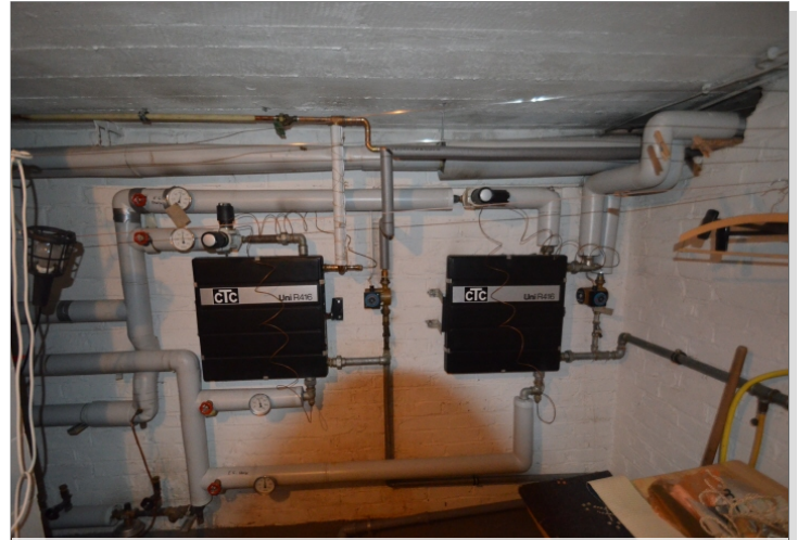
Fernwärme für 2 Wohnungen
