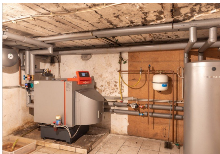
Moderne Zentralheizung mit Warmwasserboiler (2014)
