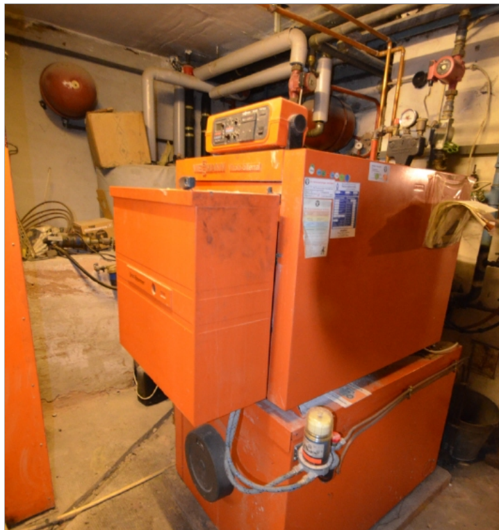
Ölzentralheizung mit Außentank
